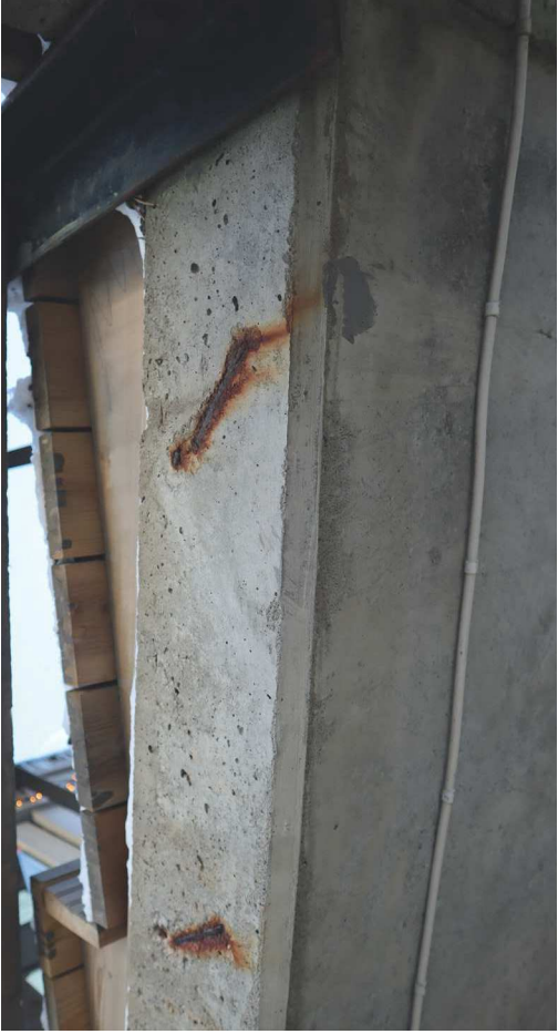
Betonin raudoituksia on näkyvissä.
