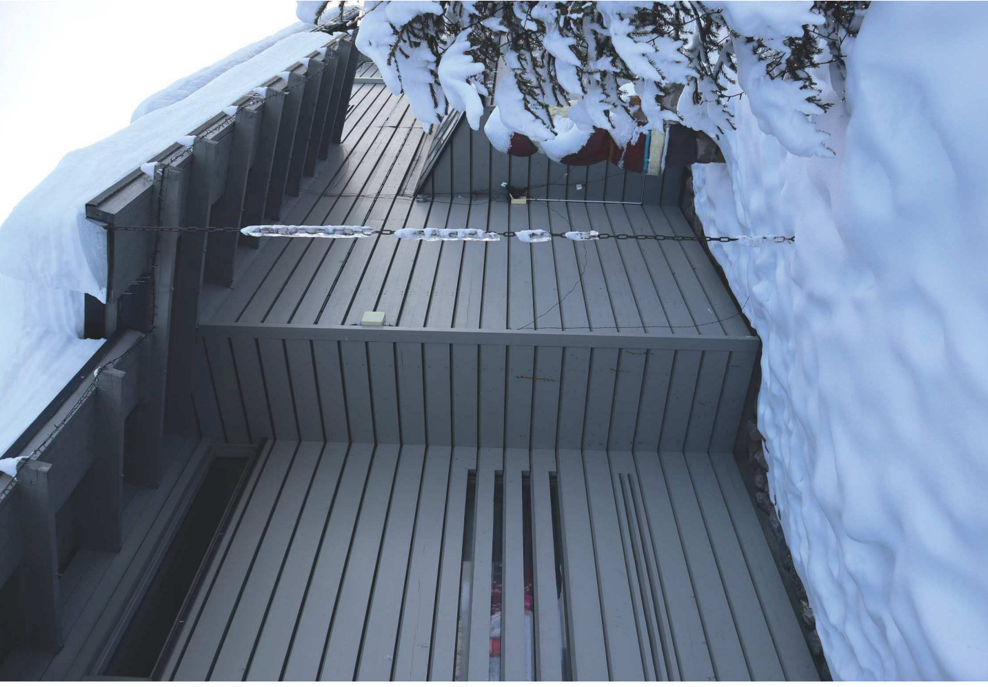
Ikkunoita on myös verhouksen takana. Nämä ikkunat ovat lähellä pohjoisjulkisivun vesikatton sadekourusta johtavaa sadekeijua.
